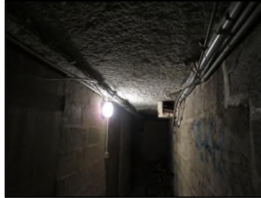
Photo N° 34 ECH-N°1 FLOCAGE -- Sous sol Plafonds cotonneux blanc
