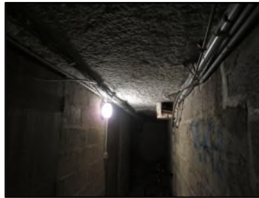
Photo N° 34 ECH-N°1 FLOCAGE -- Sous sol Plafonds cotonneux blanc
