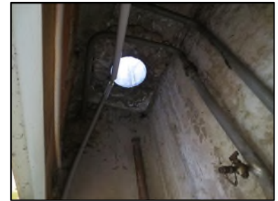
Photo N° 97 AMIANTE CIMENT Palier 4 Conduits de fluide Ventilation haute (Fibres-ciment)
