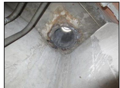
Photo N° 696 AMIANTE CIMENT 3 SAINT EXUPERY AU +4- PLACARDS GAZ Plafonds Ventilation haute (Fibres-ciment)
