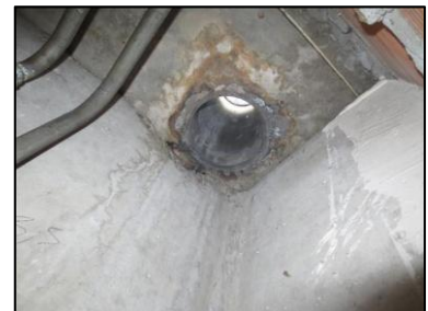
Photo N° 696 AMIANTE CIMENT 7 SAINT EXUPERY AU +4- PLACARDS GAZ Plafonds Ventilation haute (Fibres-ciment)
