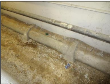
Photo N° 693 AMIANTE CIMENT 5 SAINT EXUPERY-S.sol-COULOIRS DE CAVES Planchers Chute E.U.(Fibres-ciment)
