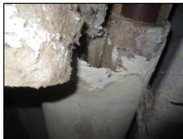
Photo N° 701 ECH-N°7 CALORIFUGEAGE 15 LORIENT- S.sol-COULOIRS DE CAVES Conduits de fluide Laine minérale + enveloppe plâtrée
