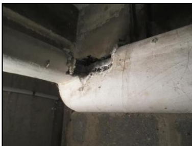
Photo N° 700 ECH-N°06 CALORIFUGEAGE 15 LORIENT- S.sol-COULOIRS DE CAVES Conduits de fluide Liège + plâtre
