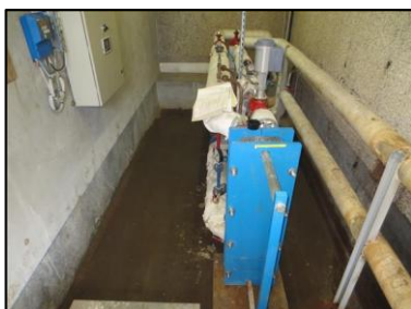
Photo N° 706 ECH-N°008 CALORIFUGEAGE SOUS STATION 15 LORIENT-S.sol-SOUS STATION Conduits de fluide Laine minérale + enveloppe plâtrée
