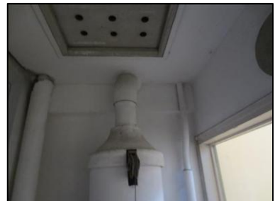
Photo N° 705 AMIANTE CIMENT 15 LORIENT- +4-LOCAL V.O Plafonds Ventilation haute (Fibres-ciment)
