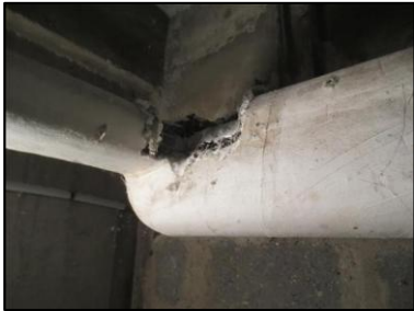
Photo N° 700 ECH-N°06 CALORIFUGEAGE 15 LORIENT- S.sol-COULOIRS DE CAVES Conduits de fluide Liège + plâtre
