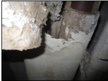
Photo N° 701 ECH-N°7 CALORIFUGEAGE 15 LORIENT- S.sol-COULOIRS DE CAVES Conduits de fluide Laine minérale + enveloppe plâtrée
