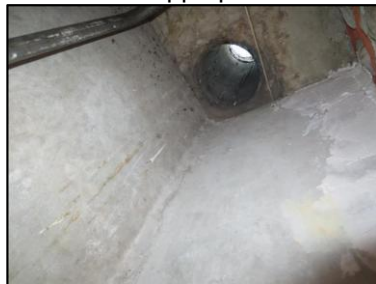
Photo N° 704 AMIANTE CIMENT 15 LORIENT-+4-PLACARDS GAZ Plafonds Ventilation haute (Fibres- ciment)
