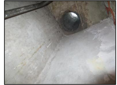
Photo N° 704 AMIANTE CIMENT 17 LORIENT- +4 -PLACARDS GAZ Plafonds Ventilation haute (Fibres- ciment)
