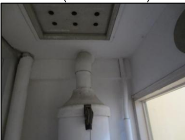
Photo N° 705 AMIANTE CIMENT 17 LORIENT- +4-LOCAL V.O Plafonds Ventilation haute (Fibres-ciment)
