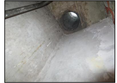
Photo N° 704 AMIANTE CIMENT 19 LORIENT- +4-PLACARDS GAZ Plafonds Ventilation haute (Fibres- ciment)
