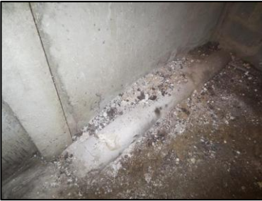
Photo N° 702 AMIANTE CIMENT 19 LORIENT-S.sol-COULOIRS DE CAVES Conduits de fluide Chute E.U.(Fibres-ciment)
