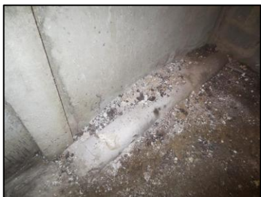
Photo N° 702 AMIANTE CIMENT 21 LORIENT-S.sol-COULOIRS DE CAVES Conduits de fluide Chute E.U.(Fibres-ciment)
