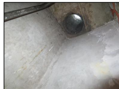
Photo N° 704 AMIANTE CIMENT 21 LORIENT +4-PLACARDS GAZ Plafonds Ventilation haute (Fibres- ciment)
