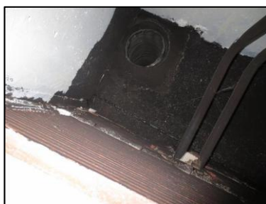
Photo N° 710 AMIANTE CIMENT 2 BLAISE- +4-PLACARDS GAZ Plafonds Ventilation haute (Fibres- ciment)
