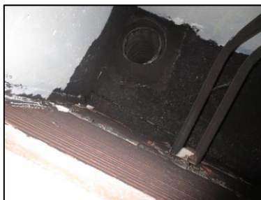
Photo N° 710 AMIANTE CIMENT 4 BLAISE--PLACARDS GAZ +4 Plafonds Ventilation haute (Fibres- ciment)
