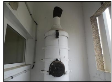
Photo N° 711 AMIANTE CIMENT 4 BLAISE--LOCAL V.O RDC à +4 Vide-ordures Gaine V.O.(Fibres- ciment)
