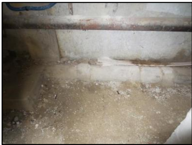
Photo N° 708 AMIANTE CIMENT 4 BLAISE-S.sol-COULOIRS DE CAVES Conduits de fluide Chute E.U.(Fibres-ciment)
