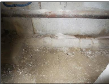
Photo N° 708 AMIANTE CIMENT 6 BLAISE-S.sol-COULOIRS DE CAVES Conduits de fluide Chute E.U.(Fibres-ciment)
