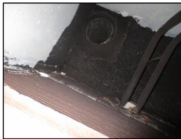
Photo N° 710 AMIANTE CIMENT 6 BLAISE--PLACARDS GAZ +4 Plafonds Ventilation haute (Fibres-ciment)
