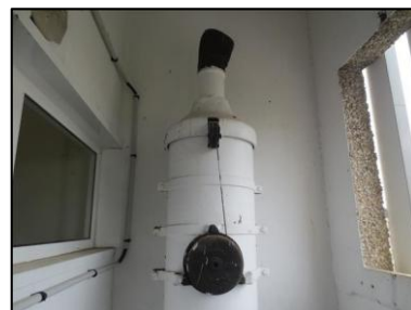
Photo N° 711 AMIANTE CIMENT 6 BLAISE--LOCAL V.O RDC à +4 Vide-ordures Gaine V.O.(Fibres-ciment)
