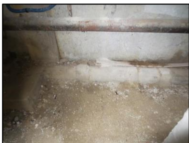
Photo N° 708 AMIANTE CIMENT 6 BLAISE-S.sol-COULOIRS DE CAVES Conduits de fluide Chute E.U.(Fibres-ciment)
