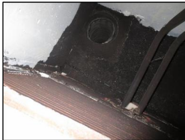
Photo N° 710 AMIANTE CIMENT 8 BLAISE--PLACARDS GAZ +4 Plafonds Ventilation haute (Fibres-ciment)
