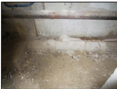
Photo N° 708 AMIANTE CIMENT 10 BLAISE-S.sol-COULOIRS DE CAVES Conduits de fluide Chute E.U.(Fibres-ciment)
