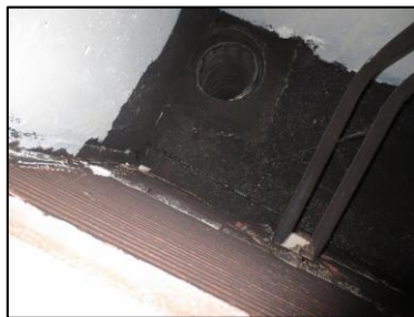
Photo N° 710 AMIANTE CIMENT 10 BLAISE--PLACARDS GAZ +4 Plafonds Ventilation haute (Fibres- ciment)
