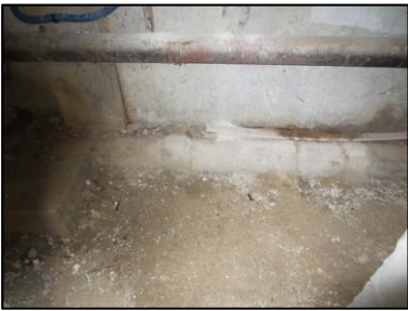
Photo N° 708 AMIANTE CIMENT 14 BLAISE-S.sol-COULOIRS DE CAVES Conduits de fluide Chute E.U.(Fibres-ciment)
