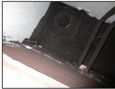
Photo N° 710 AMIANTE CIMENT 14 BLAISE--PLACARDS GAZ +4 Plafonds Ventilation haute (Fibres-ciment)
