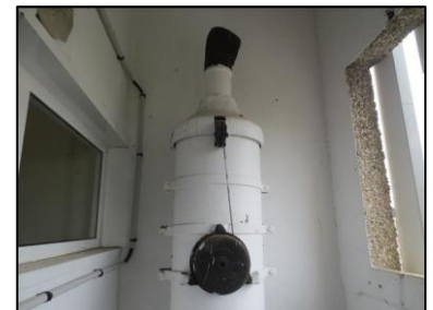
Photo N° 711 AMIANTE CIMENT 16 BLAISE--LOCAL V.O RDC à +4 Vide-ordures Gaine V.O.(Fibres-ciment)
