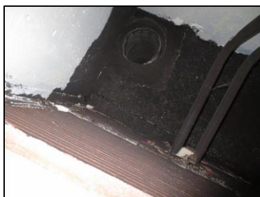
Photo N° 710 AMIANTE CIMENT 16 BLAISE--PLACARDS +4 Plafonds Ventilation haute (Fibres-ciment)
