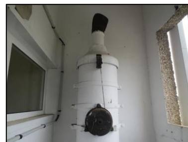
Photo N° 711 AMIANTE CIMENT 16 BLAISE--LOCAL V.O RDC à +4 Vide-ordures Gaine V.O.(Fibres-ciment)
