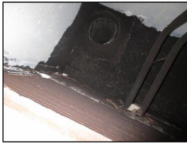
Photo N° 710 AMIANTE CIMENT 18 BLAISE--PLACARDS GAZ +4 Plafonds Ventilation haute (Fibres- ciment)
