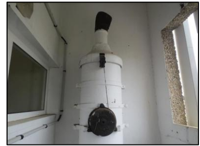
Photo N° 711 AMIANTE CIMENT 18 BLAISE--LOCAL V.O RDC à +4 Vide-ordures Gaine V.O.(Fibres- ciment)
