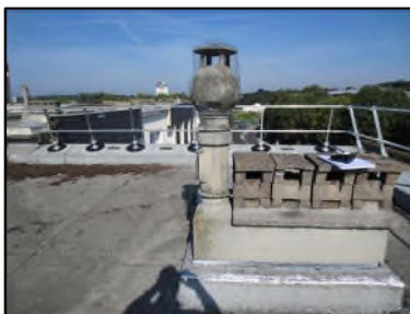
Photo N° 37 AMIANTE CIMENT -- Terrasse Conduits Ventilation haute (Fibres-ciment)
