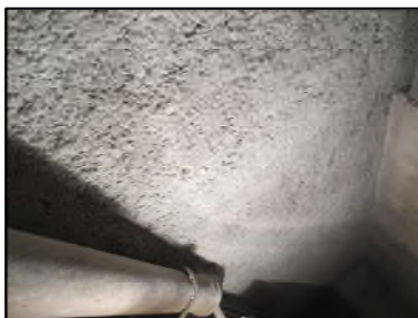
Photo N° 32 ECH-N°1 FLOCAGE -- Sous sol Plafonds Flocage
