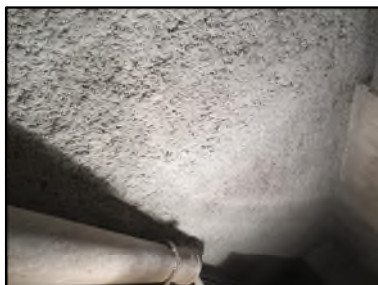
Photo N° 32 ECH-N°1 FLOCAGE -- Sous sol Plafonds Flocage
