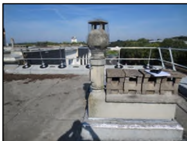
Photo N° 37 AMIANTE CIMENT -- Terrasse Conduits Ventilation haute (Fibres-ciment)
