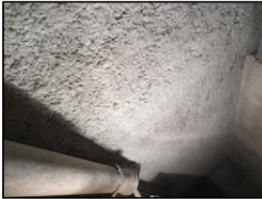
Photo N° 32 ECH-N°1 FLOCAGE -- Sous sol Plafonds Flocage
