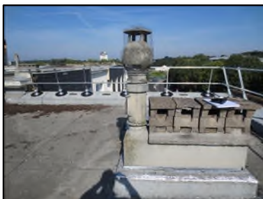
Photo N° 37 AMIANTE CIMENT -- Terrasse Conduits Ventilation haute (Fibres-ciment)
