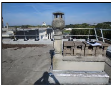
Photo N° 37 AMIANTE CIMENT -- Terrasse Conduits Ventilation haute (Fibres-ciment)
