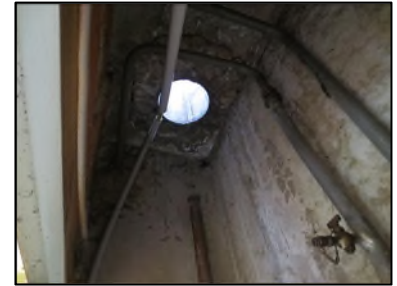
Photo N° 97 AMIANTE CIMENT 1- 4ème-Palier 4 Conduits de ventilation Ventilation haute (Fibres- ciment)
