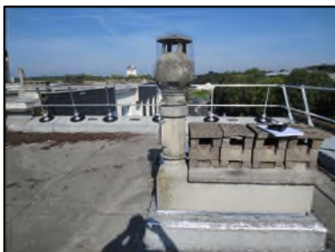
Photo N° 37 AMIANTE CIMENT -- Terrasse Conduits Ventilation haute (Fibres-ciment)
