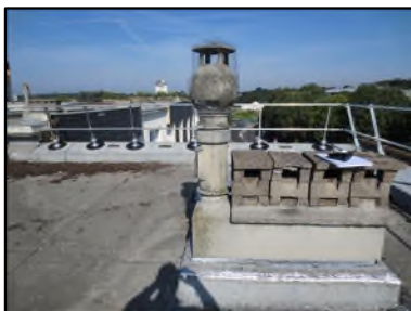
Photo N° 37 AMIANTE CIMENT -- Terrasse Conduits Ventilation haute (Fibres-ciment)
