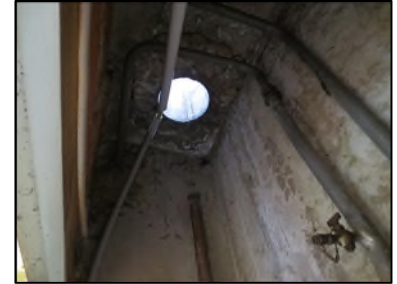
Photo N° 97 AMIANTE CIMENT -- PALIER VOLEE ESCALIER +4_NC Conduits de ventilation Ventilation haute (Fibres-ciment)
