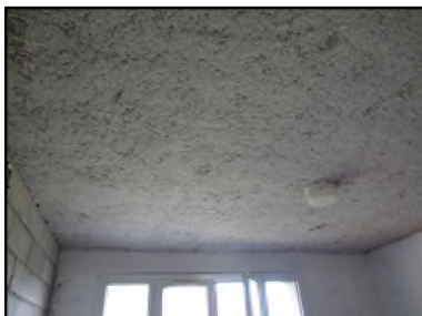
Photo N° 162 ECH-N°1 FLOCAGE -- Local vélo Plafonds cotonneux blanc
