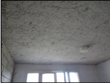
Photo N° 162 ECH-N°1 FLOCAGE -- Local vélo Plafonds cotonneux blanc
