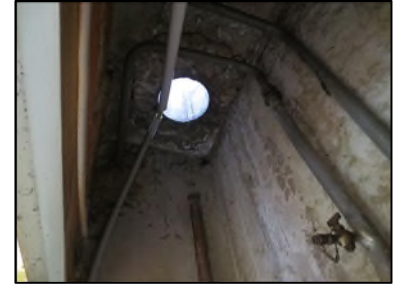
Photo N° 97 AMIANTE CIMENT -- PALIER VOLEE ESCALIER +4_NC Conduits de ventilation Ventilation haute (Fibres-ciment)
