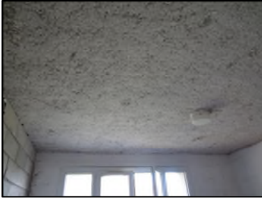
Photo N° 162 ECH-N°1 FLOCAGE -- Local vélo Plafonds cotonneux blanc
