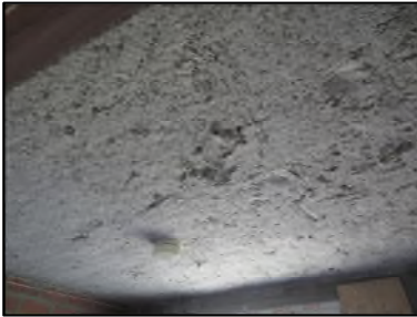
Photo N° 163 ECH-N°1 FLOCAGE -- Sous sol 1 Plafonds cotonneux blanc
