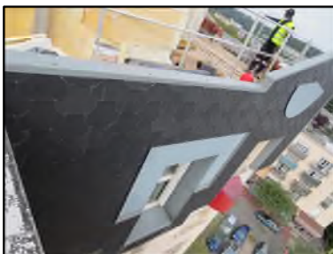
Photo N° 48 AMIANTE CIMENT -- Toiture Façade Plaques planes (Fibres-ciment)
