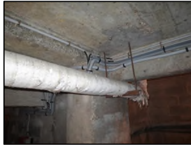
Photo N° 165 ECH-N°2 CALORIFUGEAGE Sous sol 2 Conduits de fluide Laine minérale + enveloppe plâtrée
