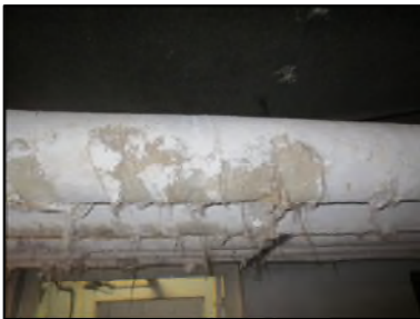
Photo N° 529 ECH-N°2 CALORIFUGEAGE COULOIR CAVE_S.sol Conduits de fluide Laine minérale + enveloppe plâtrée
