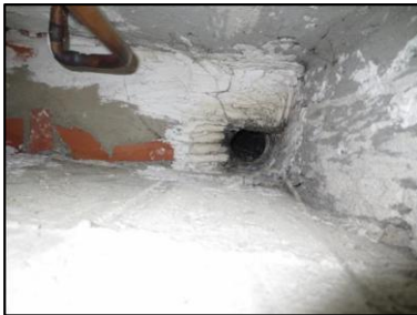
Photo N° 1160 AMIANTE CIMENT - -nc-PLACARDS TECHNIQUE GAZ +4 Conduits Ventilation haute (Fibres-ciment)
