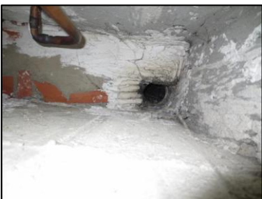
Photo N° 1160 AMIANTE CIMENT - -nc-PLACARDS TECHNIQUE GAZ +4 Conduits Ventilation haute (Fibres-ciment)
