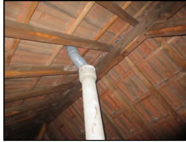
Photo N° 433 AMIANTE CIMENT Combles Conduits Ventilation haute (Fibres-ciment)
