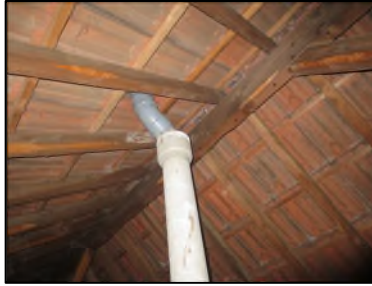
Photo N° 433 AMIANTE CIMENT Combles Conduits Ventilation haute (Fibres-ciment)
