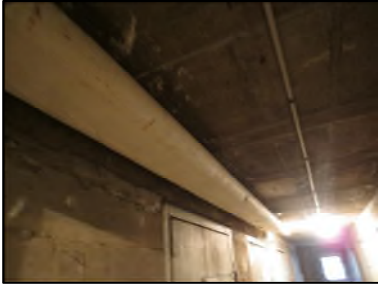
Photo N° 427 ECH-N°1 CALORIFUGEAGE COULOIR DE CAVE Conduits de fluide Laine minérale + enveloppe plâtrée
