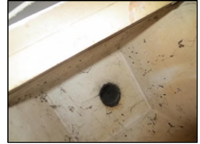
Photo N° 436 AMIANTE CIMENT Gaine technique Gaz 3 Conduits Ventilation haute (Fibres-ciment)
