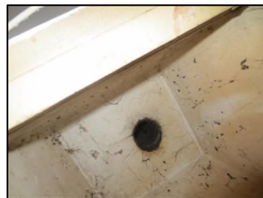
Photo N° 436 AMIANTE CIMENT Gaine technique Gaz 3 Conduits Ventilation haute (Fibres-ciment)
