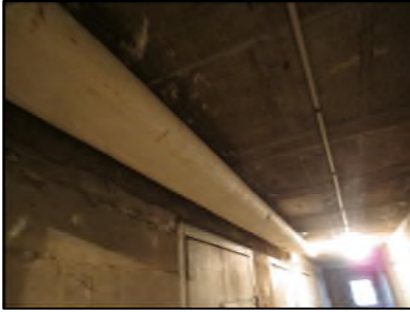
Photo N° 427 ECH-N°1 CALORIFUGEAGE COULOIR DE CAVE Conduits de fluide Laine minérale + enveloppe plâtrée
